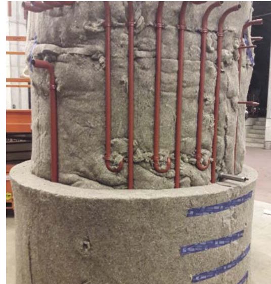
Auch die Dämmung der Gebäudetechnik , etwa die eines Warmwasserspeichers, ist mit Schafwolle möglich.
